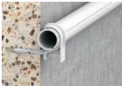
Färdig installation av typ 1974
