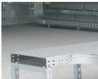
Gångbart kabelrännesystem Gångbart kabelrännesystem, uppställt på U-profilkonstruktion.
