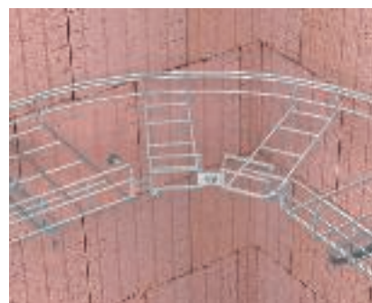
Horisontalbøj Utförande av en horisontalbøj vid C-trådsteigar med hörnförbindning av typen GEV 36.
