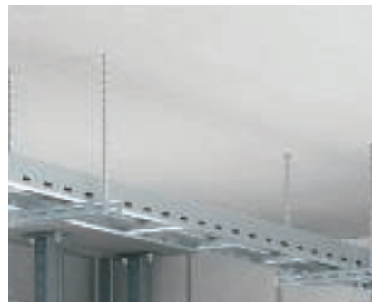
Gängstångsupphängning. Upphängning av en kabelstege med gängstänger och U-profil.
