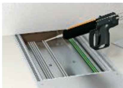
Pressa in brandskyddsskummet direkt under väggen
