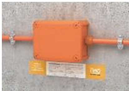
Färdiginstallerad FireBox med märkskylt
