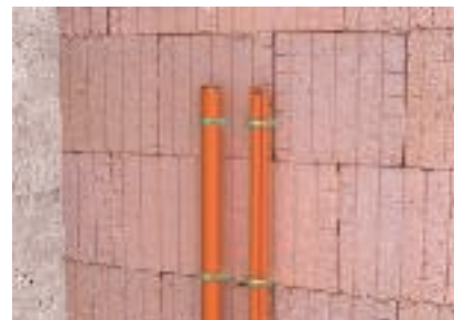
Lodrat kabelinstallation som enkel- och buntdragning på väggen
