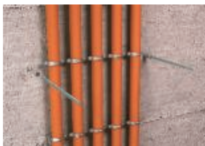
Fästpunkter bredvid kablarna direkt på väggen
